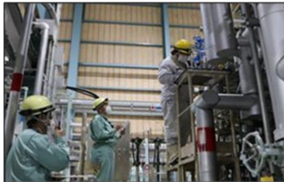
ボイラ日常点検の作業を確認 (再処理工場ボイラ建屋)
