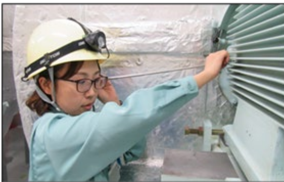
聴診棒で送風機の異音を確認 (再処理工場)
